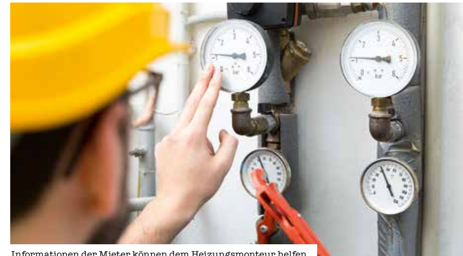
Informationen der Mieter können dem Heizungsmonteur helfen.
